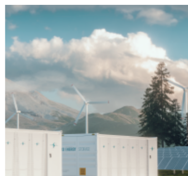
智慧光储充能源管理平台
